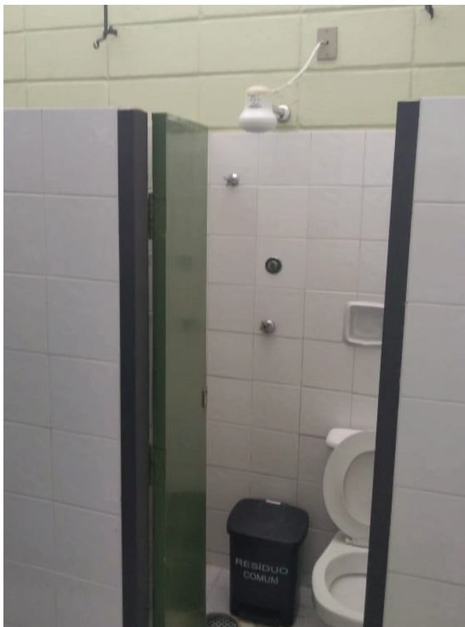
Figura 27: O chuveiro na UBS Jd. Japão, instalado por conta da chegada da equipe do SAMU, é a síntese da improvisação generalizada desfechada pela publicação da Portaria 190/2019-SMS.G.
