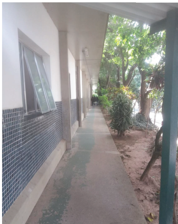
Figura 23: No ponto de assistência do HM Dr. Alexandre Zaio (V. Nhocuné), o vestiário com chuveiro se encontra a mais de 300 metros da sala da equipe e do estacionamento da ambulância do SAMU.
